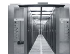
GABINETES Y CONTENCIÓN DE PASILLOS
