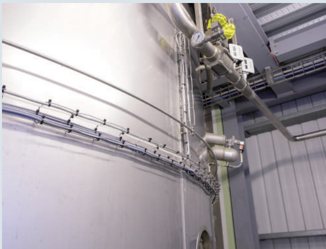
En tinas y silos
